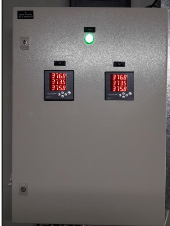
Figura 3: Vista de tablero cerrado
