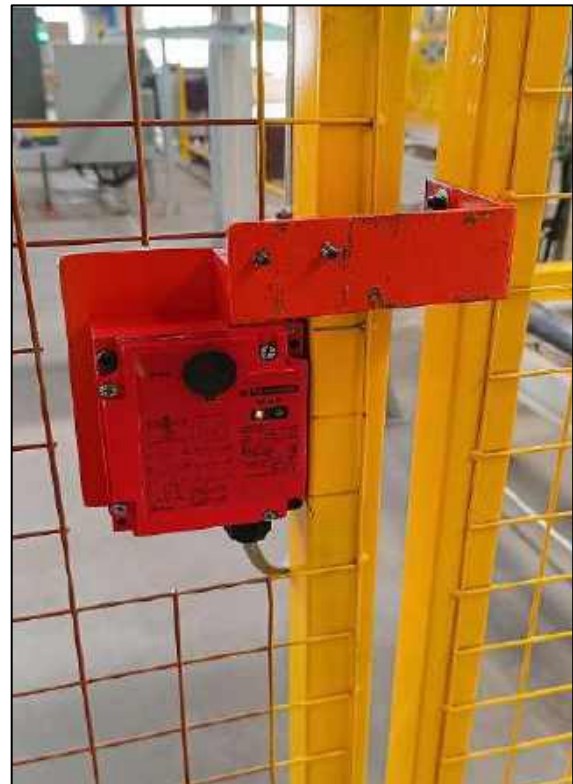
Figura 26 - Interruptor de seguridad
