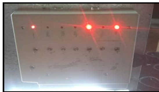
Ilustración 47. Tablero de control ocho llaves de dos puntos.
